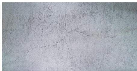
写真1 床コンクリートのひび割れ
